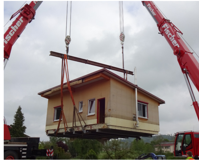
Für den Bau des Geschäfts- und Ärztehauses in der Ortsmitte Waldtanns musste das erhaltenswerte Bürogebäude der ehem. Fa. Feudel weichen. Es steht nun gegenüber dem Rathaus.
